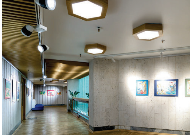
Шестиугольные светильники установлены и в холле перед концертным залом
